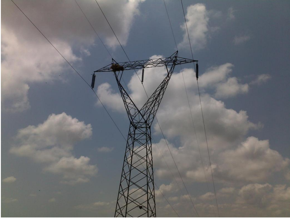
Şekil 4.9: Elektrik direği üstünde yuva
